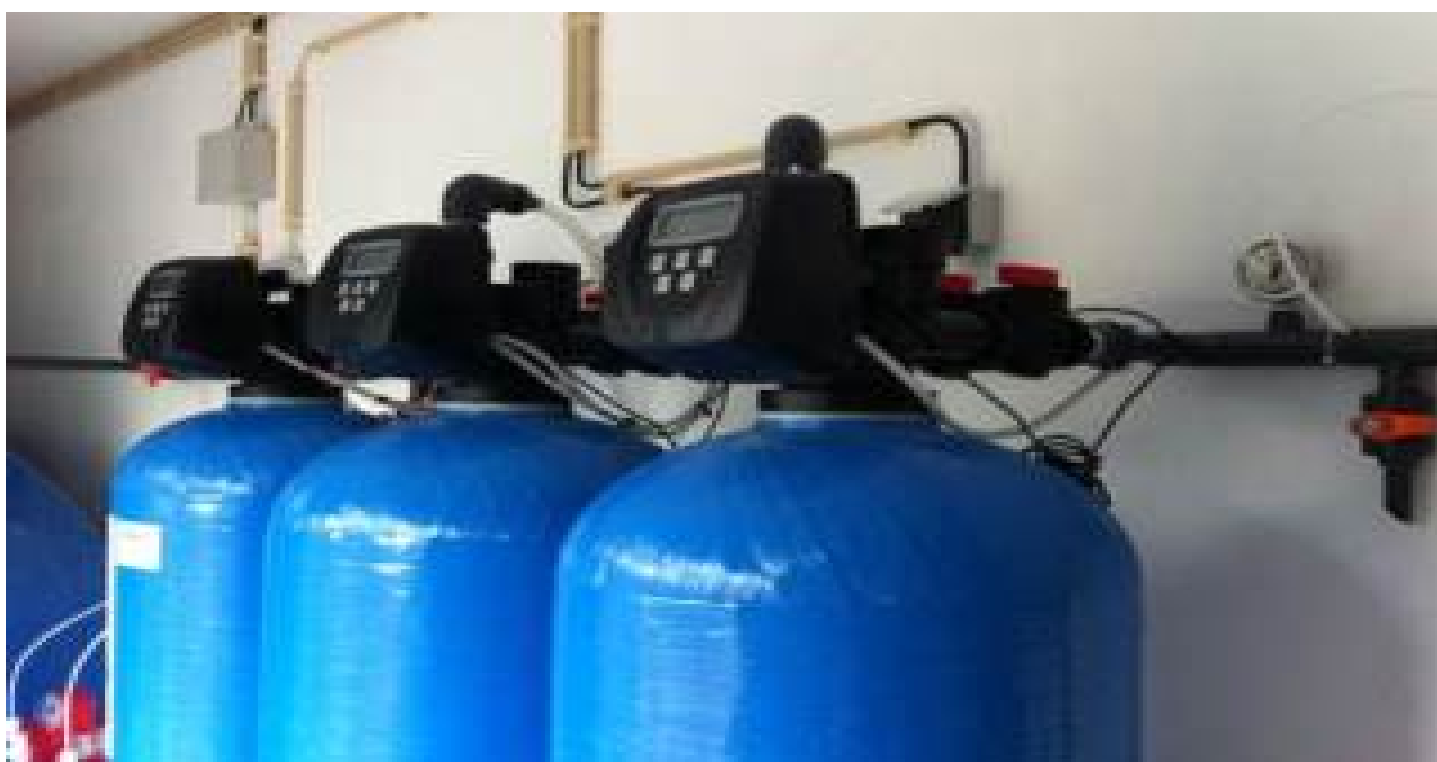
Tratamento de Água
