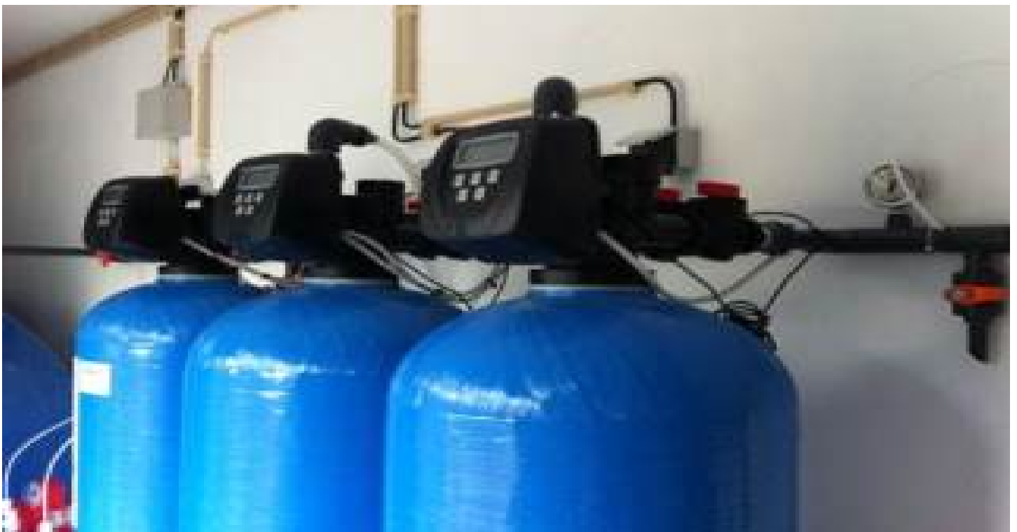
Tratamento de Água
