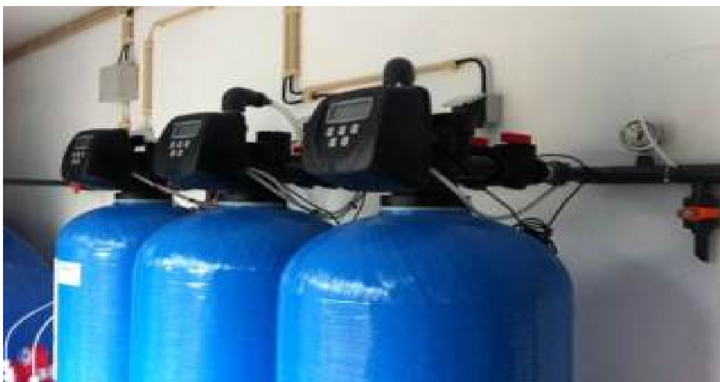
Tratamento de Água
